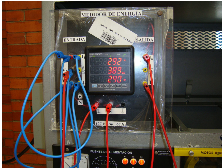
Fig. 5.10.14 Potencia registrada 292 W
