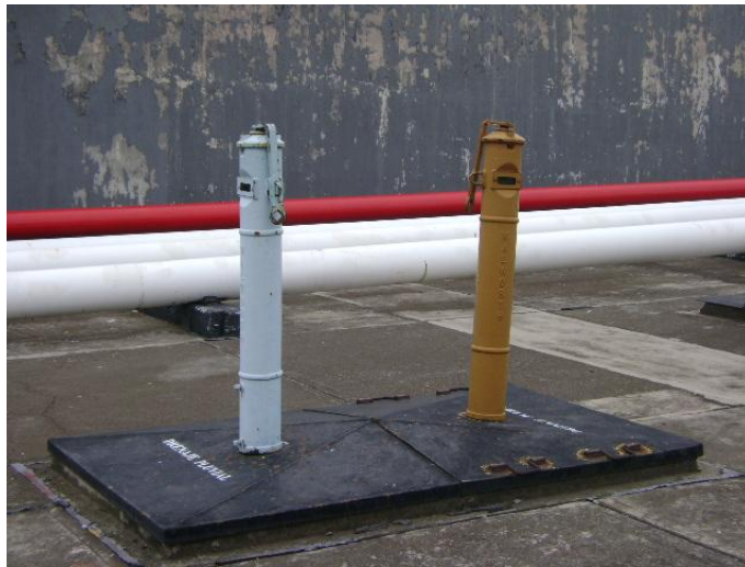
Figura 4.20 (Válvulas del drenaje pluvial y aceitoso)
