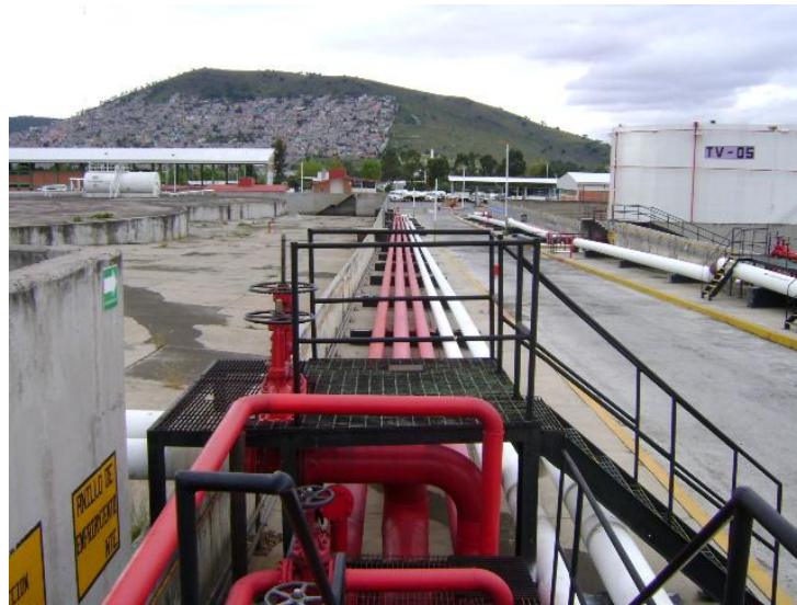
Figura 4.19 (Red de agua contra incendio)
