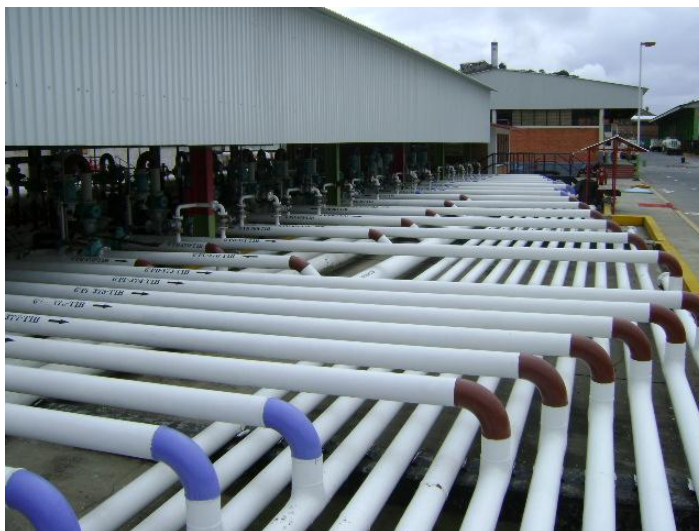
Figura 4.13 (Casa de bombas)
