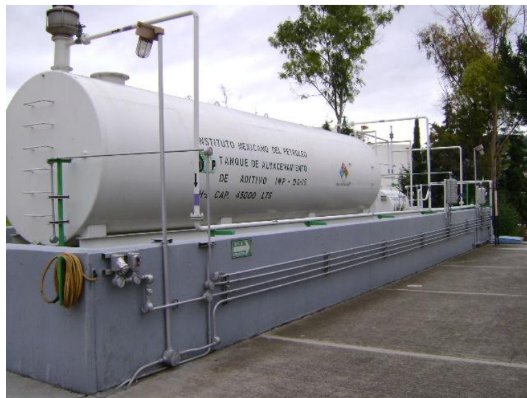
Figura 4.17 (Tanque de aditivo)
