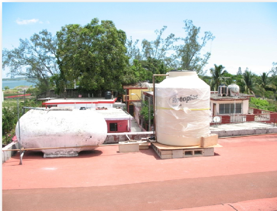
Figura 5.8.1 Tinaco para almacenamiento superior.
