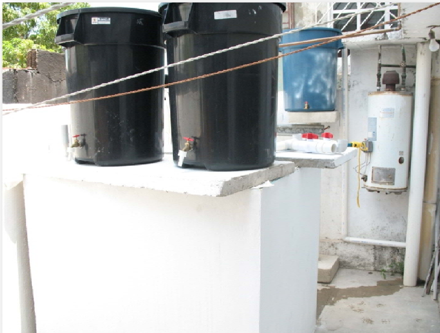
Figura 5.6.1 Tanques utilizados como filtros lentos de arena.
