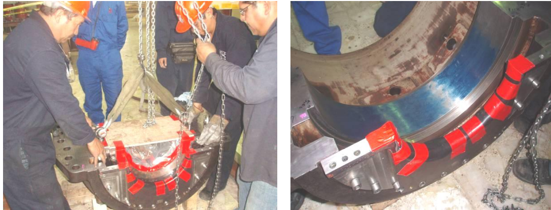
Figura 3.19. Centrar grúa en pedestal de chumacera 2 e iniciar montaje lentamente con grúa
