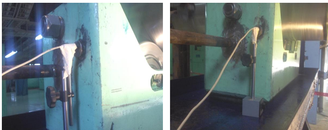
Figura 3.24. Cajas de los rodillos de balanceo donde van puestos los sensores para medir las vibraciones
