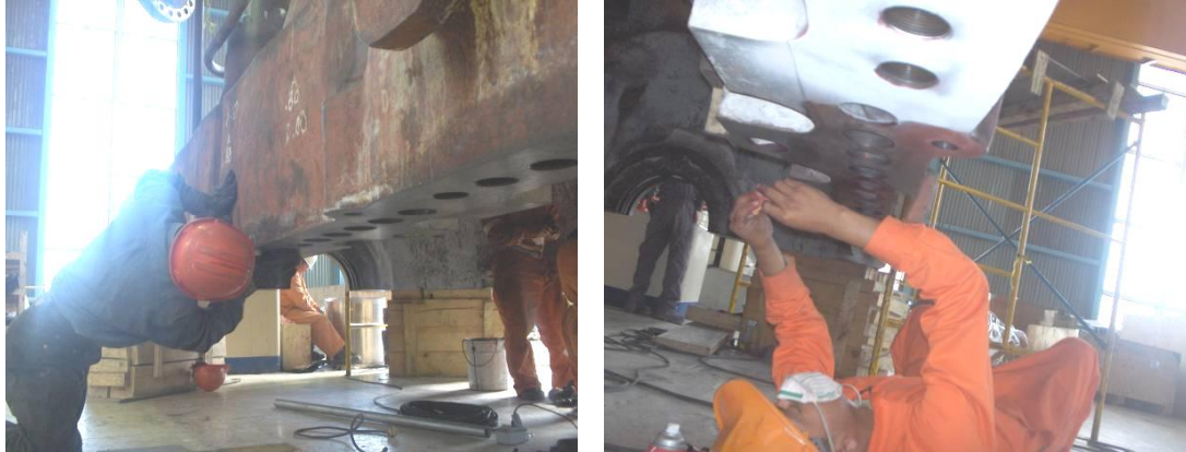
Figura 3.4 Inspeccion visual carcasa exterior superior.
