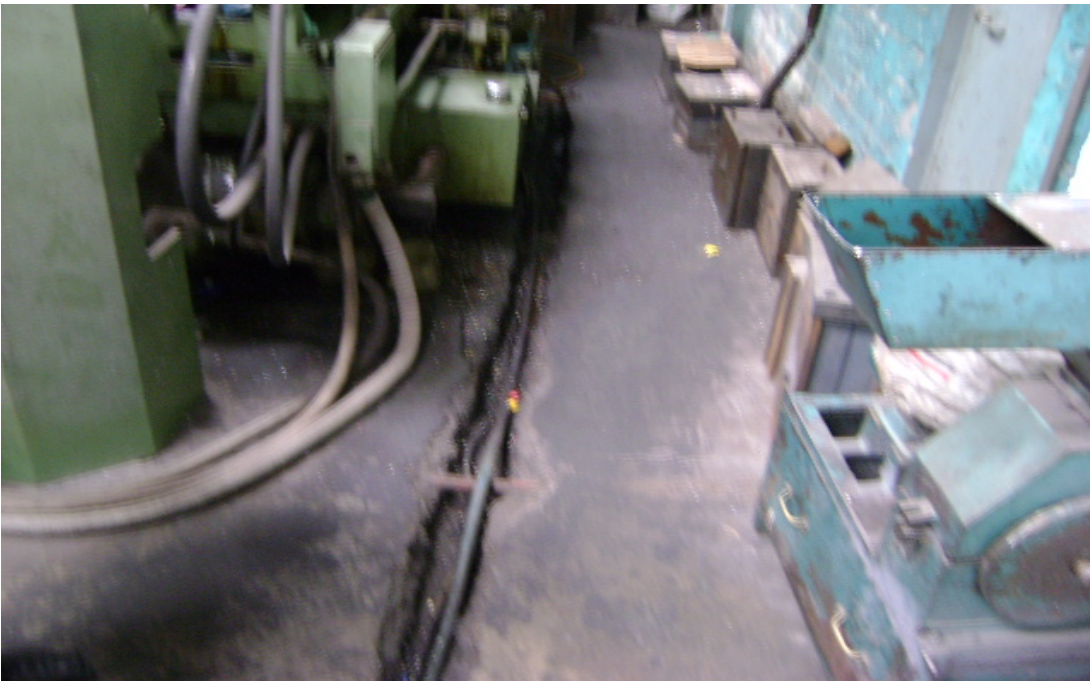
Foto 4.15 Mangueras de maquinaria en ranura sin protección.
