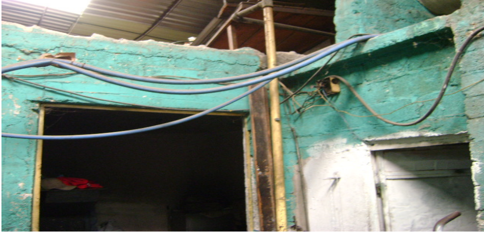
Foto 4.12. Algunas mangueras de agua se encuentran colgadas sin estar sujetas.
