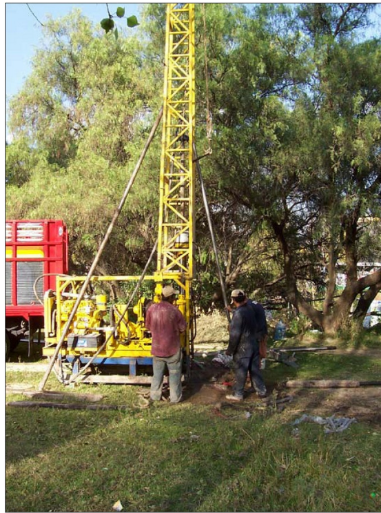
VISTA GENERAL DEL EQUIPO DE PERFORACION LONGYEAR MOD 34 QUE FUE UTILIZADO EN LOS TRABAJOS DE EXPLORACIÓN GEOTECNICA. SE OBSERVA SOLO A EL OPERADOR Y DOS DE SUS AYUDANTES.
