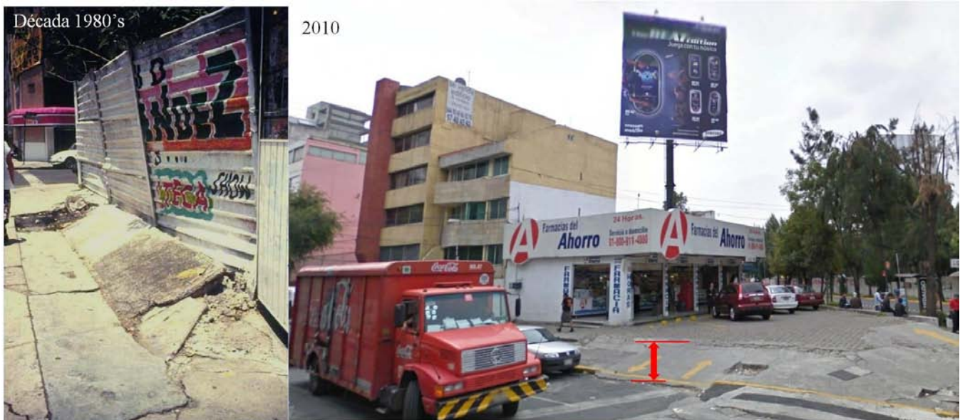
Figura 2.62. Emersión aparente de una cimentación abandonada en el cruce de Insurgentes y Yucatán.
