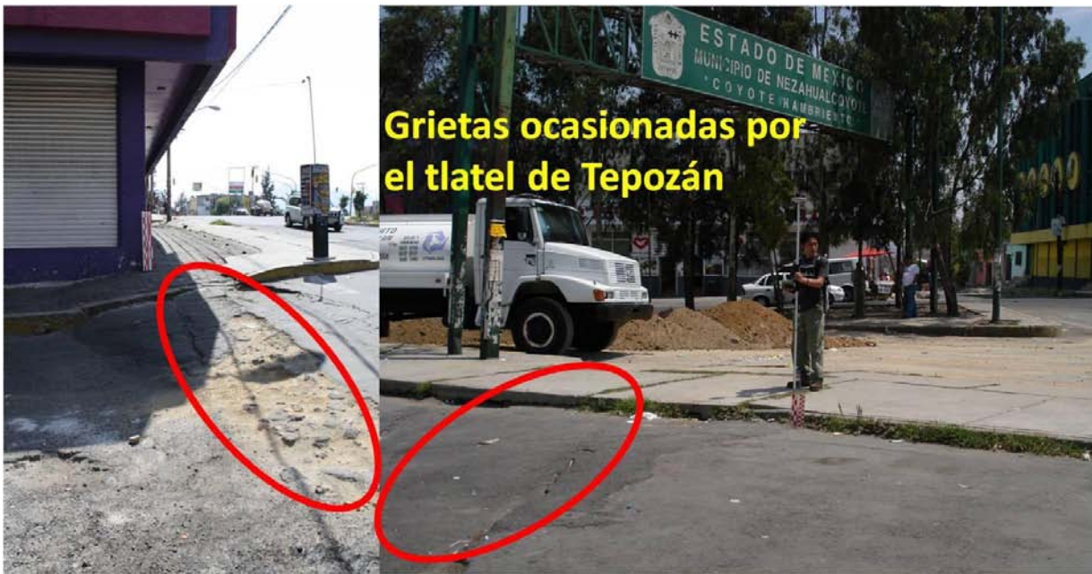
Figura 2.52. Grietas en los alrededores del tlatal de Tepozán
