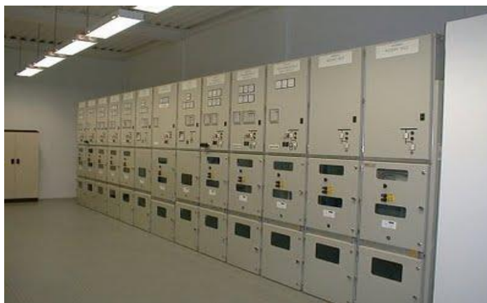
Ilustración 57. Tablero Metal Clad
