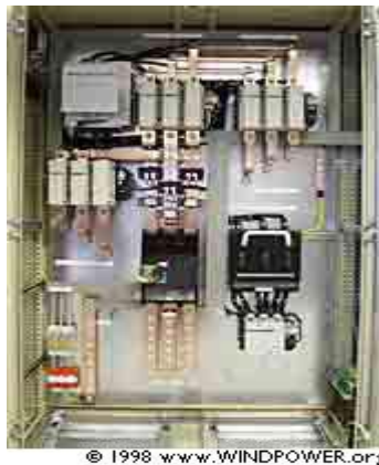
Ilustración 36. Parte de alta tensión de un controlador de una máquina de 1 megawatt.
