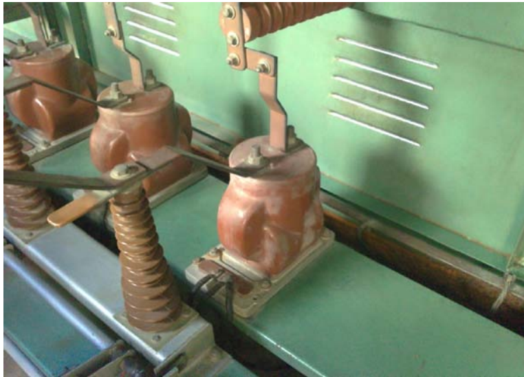
Fig. 1.16 Transformadores de corriente
