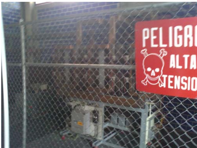
Fig. 2.11 Rectificador de una subestación eléctrica rectificadora.
