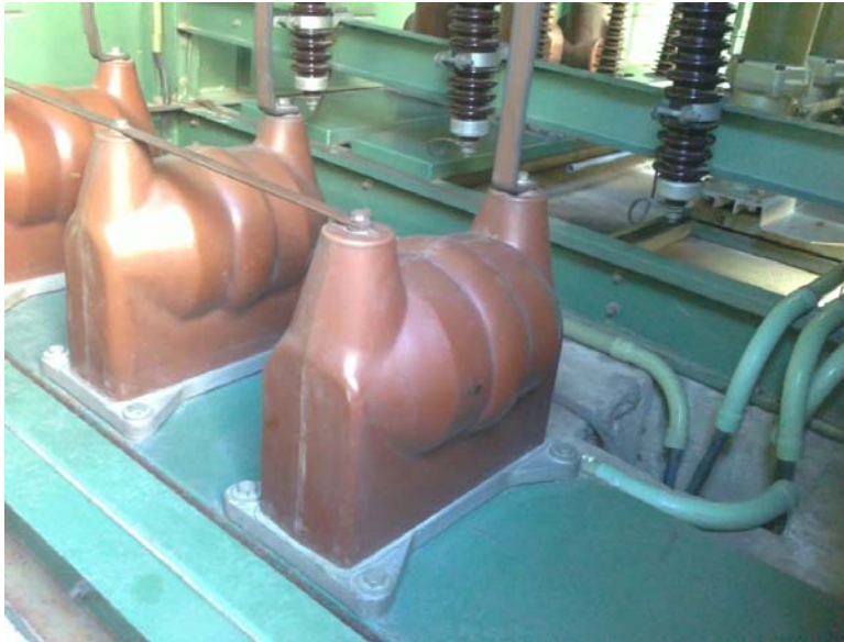
Fig. 1.17 Transformadores de potencial.
