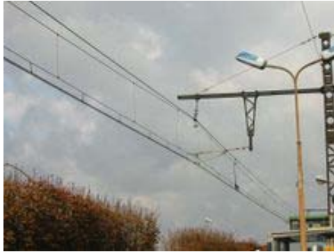
Fig. 1.8. Catenaria aérea flexible
