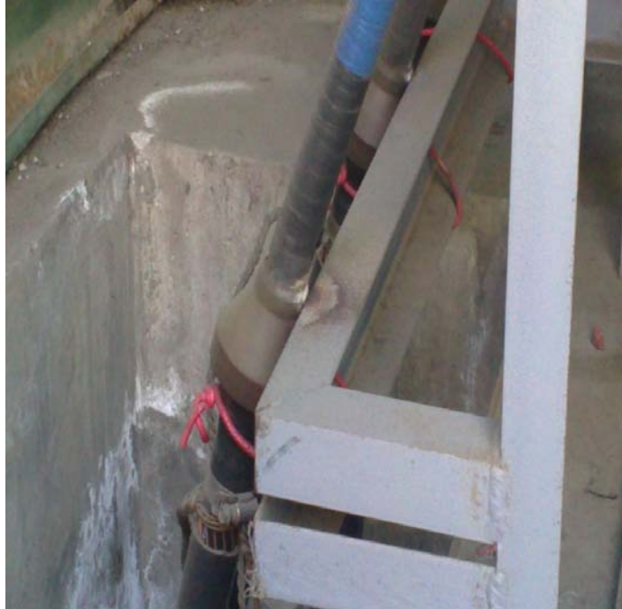
Fig. 3.4 Falta de consideración de distancia de aislamiento.
