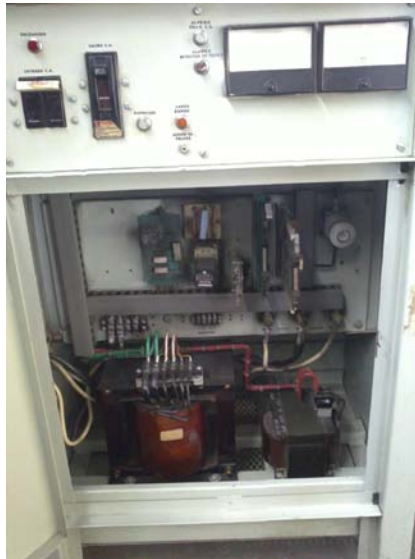
Fig.2.15 Interior de un cargador de baterías sin partes móviles.
