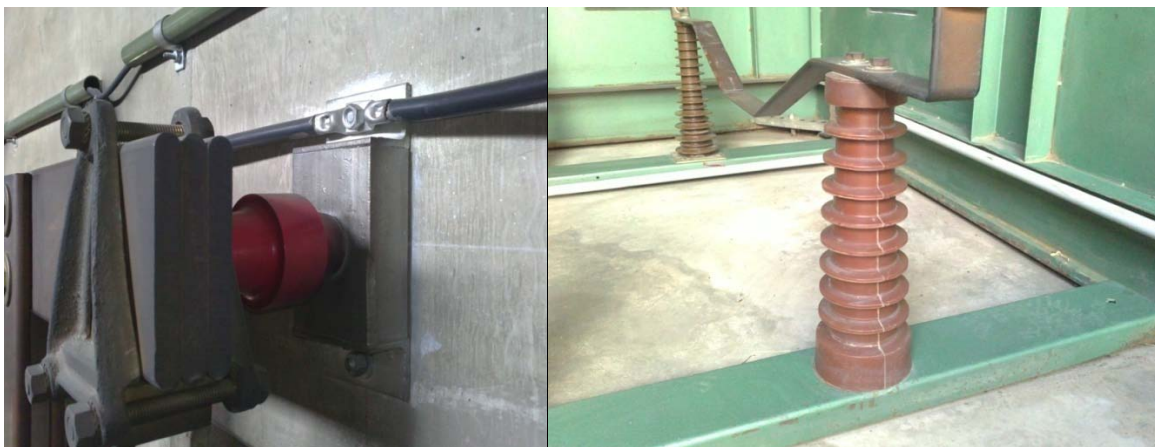
Fig. 3.3 Distancia de aislamiento en CD y CA con base del aislador a tierra.
