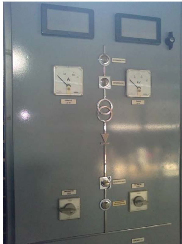
Fig. 2.16 Tablero de control.
