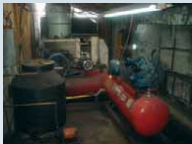
Vista del cuarto de compresores [Archivo personal].
