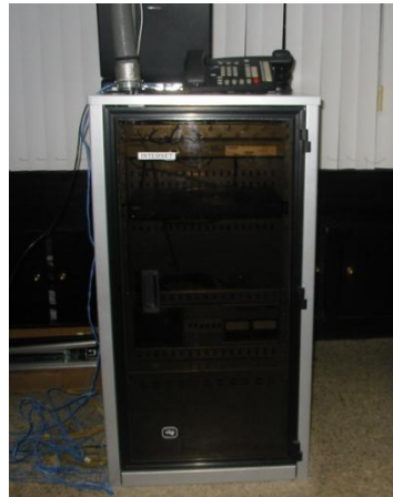
Fig. 99 Distribuidor de Acceso a Internet
