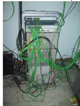
Fig. 72 Distribuidor de red saturado
