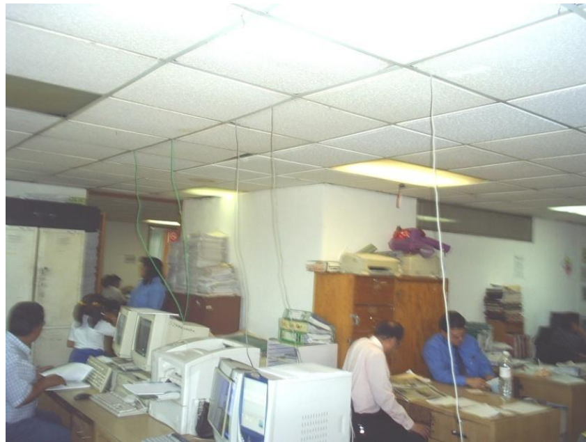
Fig. 75 Improvisación de Cableado
