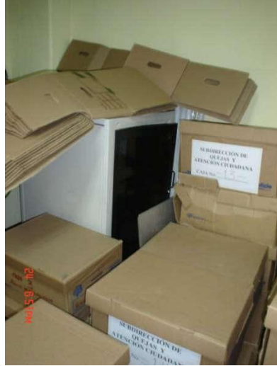
Fig. 73 Distribuidor de red invadido
