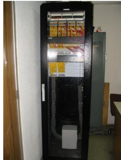
Fig. 87 Gabinete de Acceso a Usuarios
