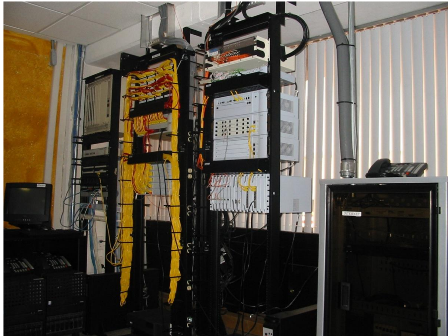
Fig. 85 Centro de Computó Principal (SITE)
