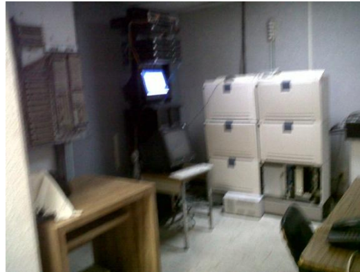
Fig. 88 Equipo de conmutación PBX
