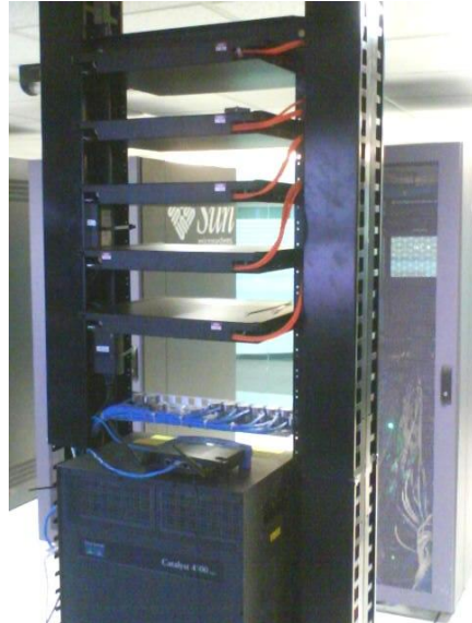
Fig. 80 Distribuidor principal de fibra óptica
