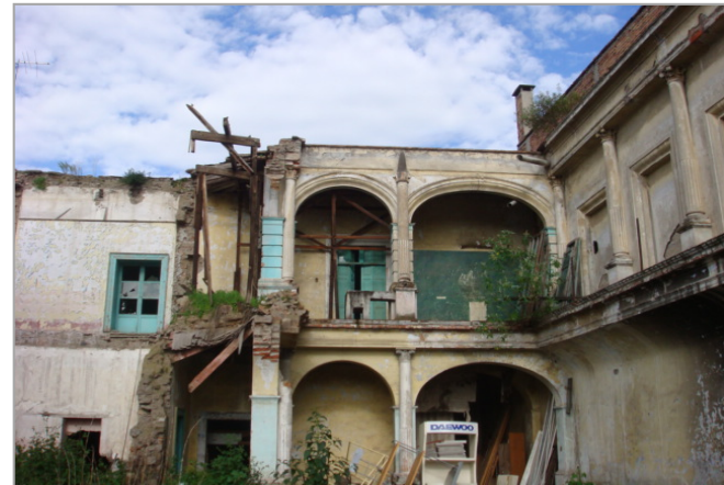
F89. En el interior del inmueble se puede apreciar el estado ruinoso en el que se encuentra, se observan claramente los elementos ornamentales y estructurales
