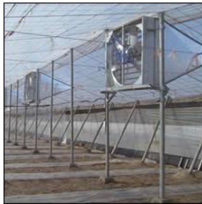
Fig. 2.15 Ventilación mediante el empleo de ventiladores en un invernadero. 25
