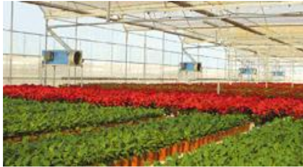
Fig. 2.9 Generador de aire caliente en un invernadero. 19
