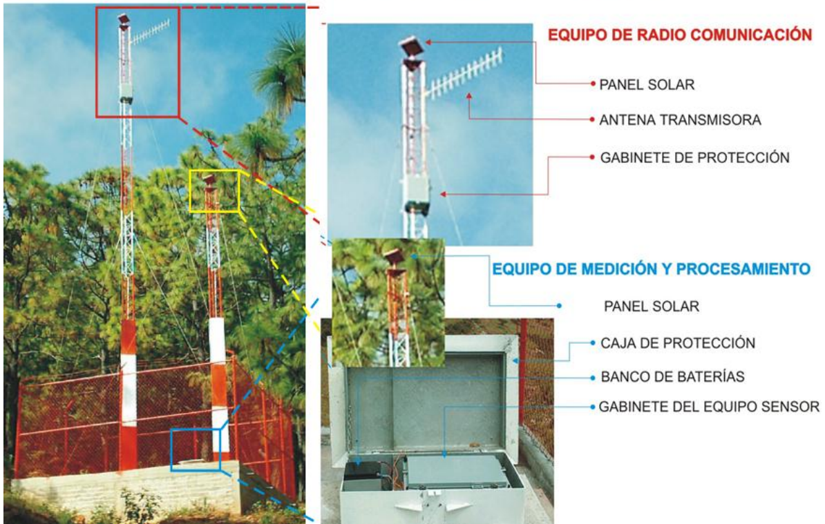
Figura 2.3. Aspecto general de una ESDECA típica
