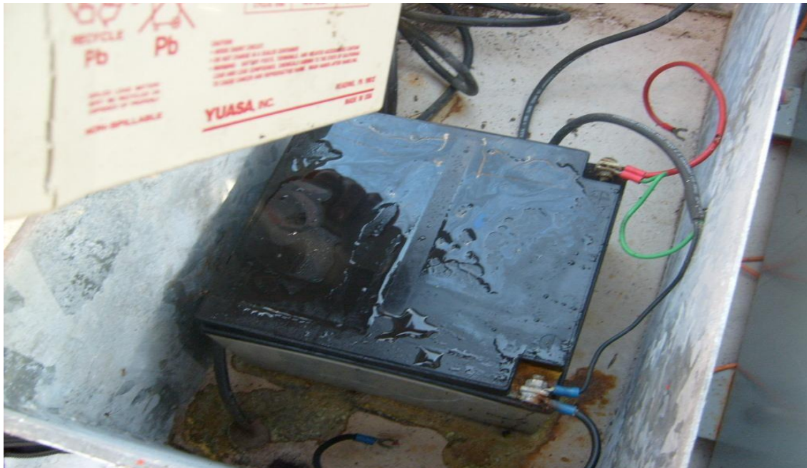
Figura 3.2 Aspectos generales del deterioro de las baterías. Derramamiento del acido
