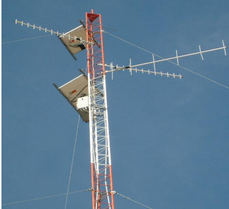
Figura 2.9 Aspecto de la torre donde instala en equipo de comunicaciones. Se observan 2 paneles solares y antenas de radiocomunicación.
