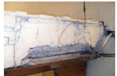
Gráfico 14. Desprendimiento de concreto en trabe en planta baja.
