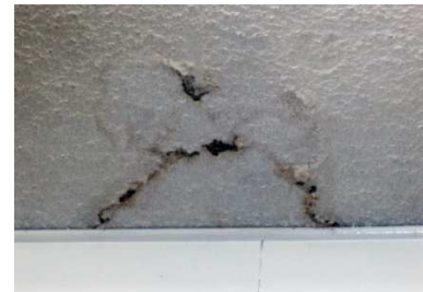
Gráfico 13. Plafón en Estacionamiento afectado por humedad.
