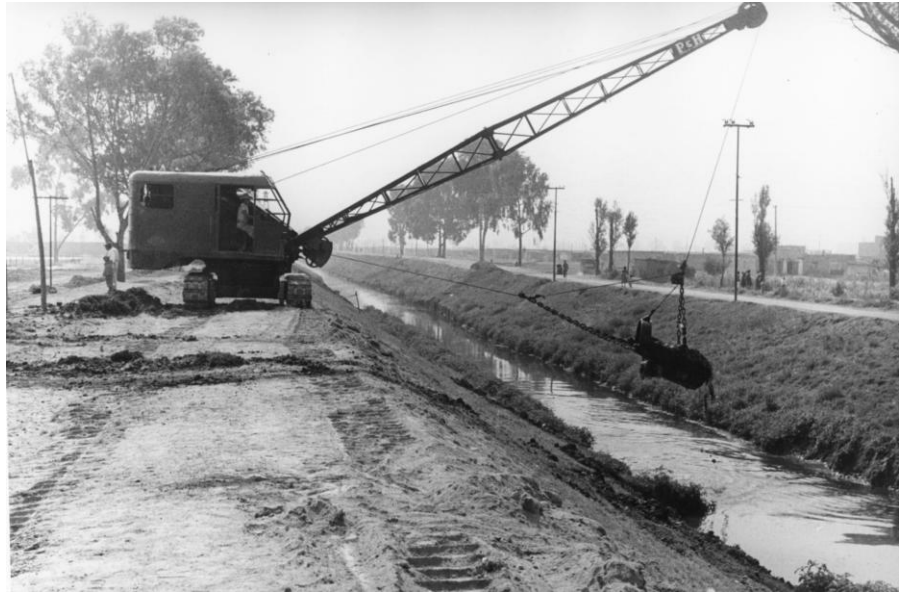
FIGURA 129. Anónimo, sin título, s/f. Se van realizando obras de ingeniería civil, como dragar los canales dando paso a una infraestructura moderna. 441
