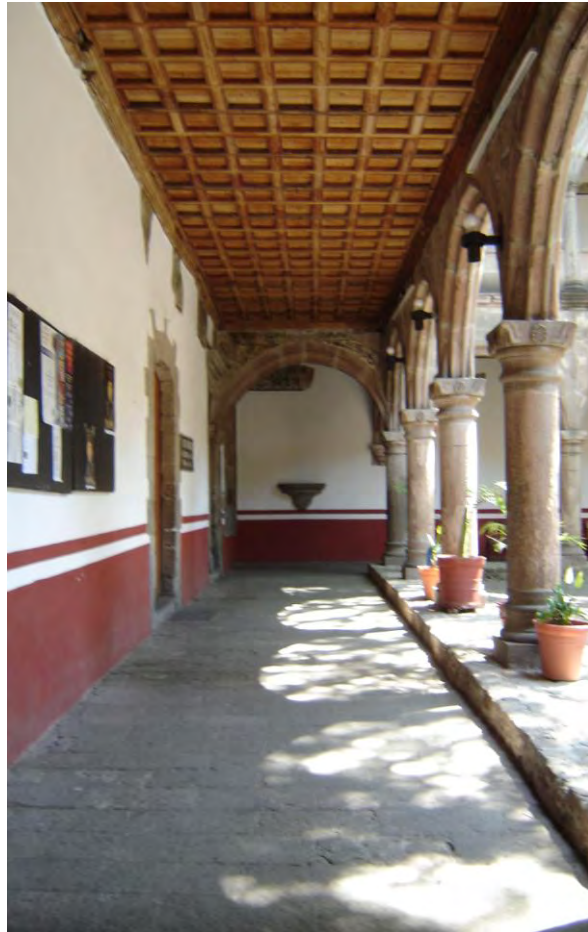
FIGURA 235. Forjado de piso bidireccional en una de las galerías del claustro bajo del convento del templo de los Santos Apóstoles Felipe y Santiago, en Azcapotzalco. Fotografía de Irene Pérez Rentería, 2008.
