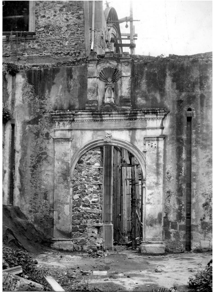
FIGURA 173. Anónimo, la obra en proceso. Detalle de la salida tapiada al viejo cementerio y el aumento de altura de los muros laterales de la fachada norte del templo. 307 También se observa el mal estado del inmueble.
