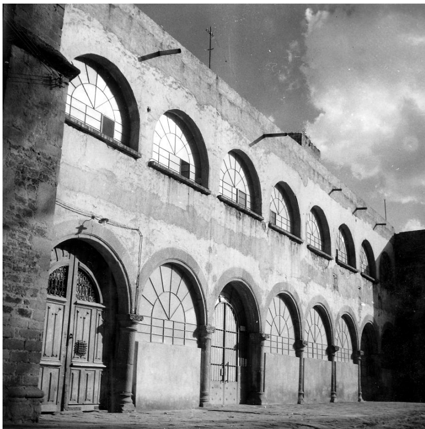
FIGURA 203. Anónima, se enjarraron los muros del portal de peregrinos, según la solicitud del párroco. En 1945, la fachada se encontraba en regular estado, para 1968 se hacen aplanados, mientras que los espacios arquitectónicos corresponden a los registrados en el levantamiento de 1952. 690
