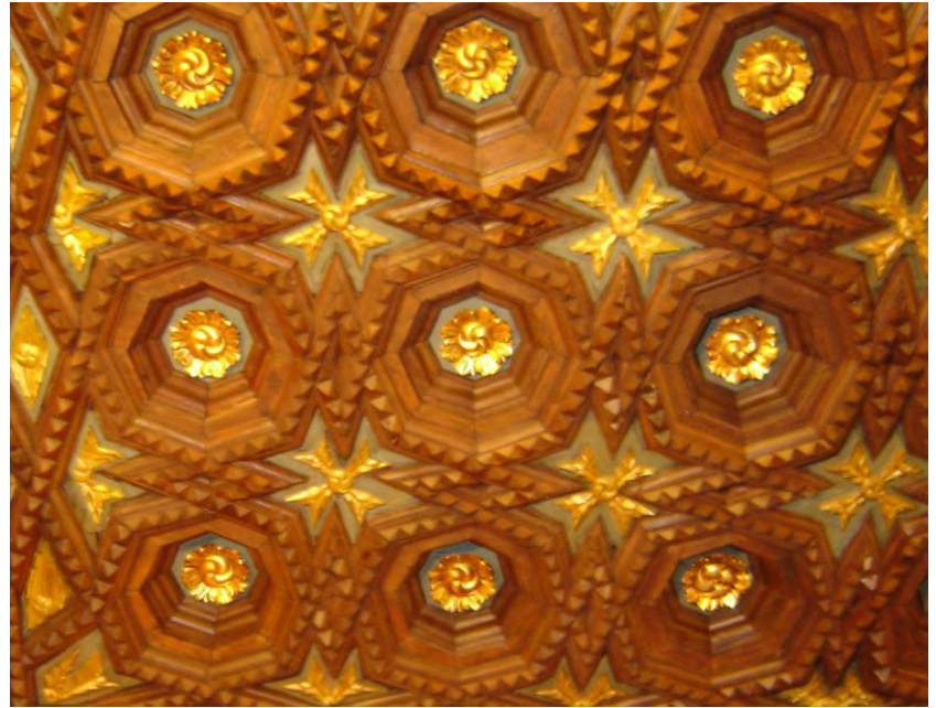
FIGURA 366. Detalle del artesonado en la antigua sacristía del Hospital de Jesús. Fotografía de Irene Pérez Rentería, 2009.
