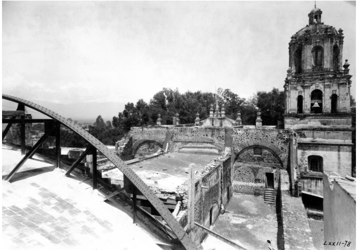
FIGURA 176. Anónimo, Obra en proceso de terminación. La bóveda de medio cañón concluida, 609 faltando por terminar la unión con la techumbre del coro. Nótese la armadura soporte de la bóveda, el remache en las soleras y los ángulos de acero.
