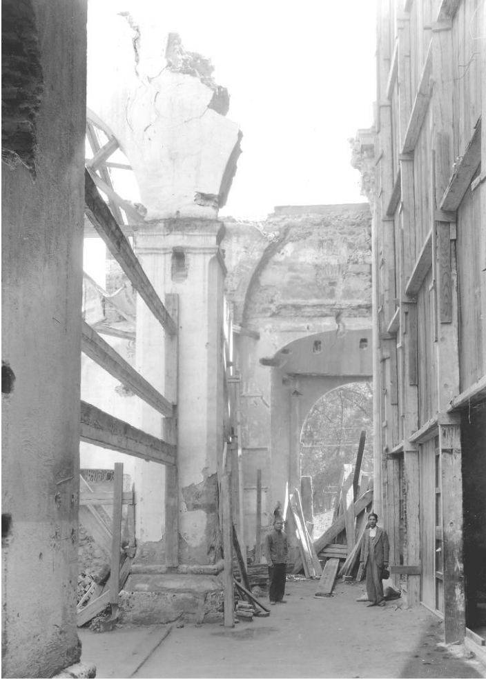
FIGURA 172. Luis Limón, Vista interior del templo, 596 en él permanecen aún de pie los pilares interiores, idea original de 1923. Posteriormente, éstas también se demolerían.
