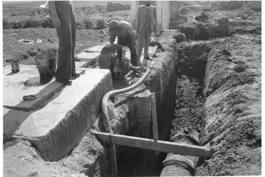
FIGURA 130. Anónimo, sin título, s/f. Construcción de cárcamos de bombeo para desecar la cepa y tener una superficie de agua para la colocación de la tubería de drenaje. 442
