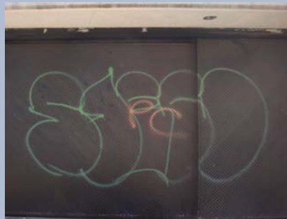
Calz. Las Águilas # 590 Uso: Habitacional Tipo de graffiti : Tag Soporte: Metal
