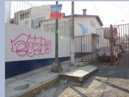
Calz de los Leones S/N Uso: Habitacional Tipo de graffiti : Tag Soporte: Aplanado
