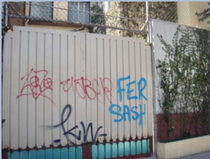
Calz. Las Águilas # 574 Uso: Habitacional Tipo de graffiti : Tag Soporte: Metal
