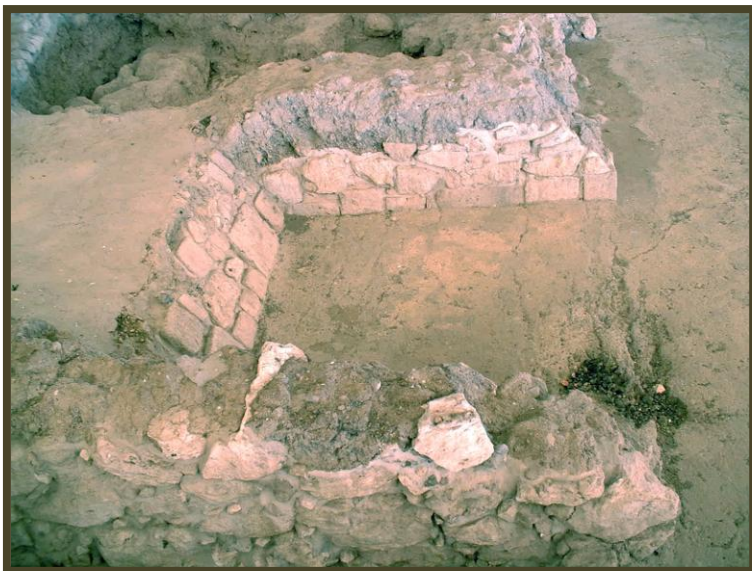
▲ FOT. HUGO HERNÁNDEZ H. Detalle de sistema constructivo a base de piedra-lodo, en la Zona Arqueológica de Cacaxtla, Tlaxcala.
