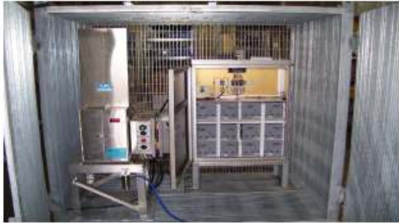
Figura 3.8 Unidad del Generador Termoeléctrico 6 .
