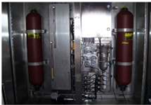
a) Sistema Hidráulico superficial y Acumuladores
