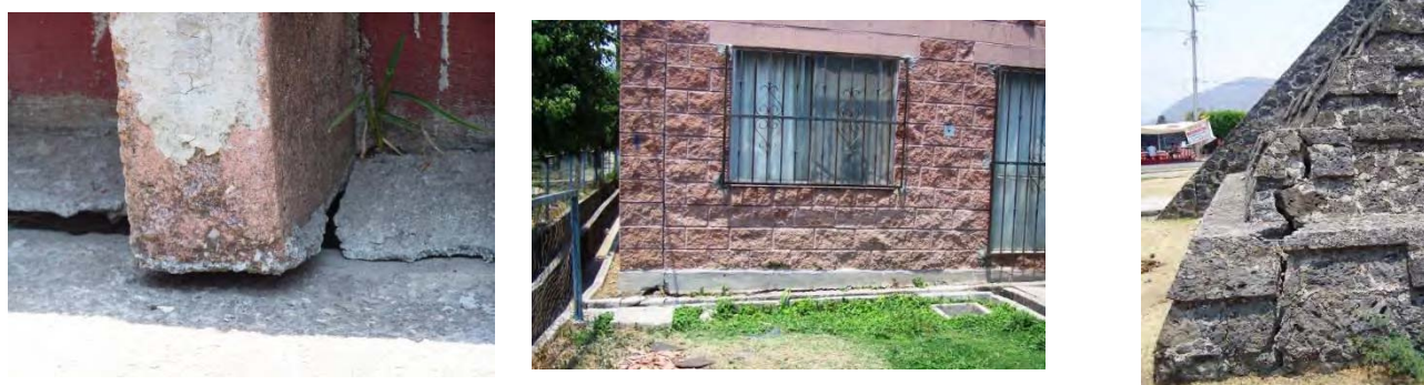
Imagen I.3. Daños debido a las arcillas expansivas. Morelos, México. Daños tales como levantamientos de losas y grietas en estructuras.
