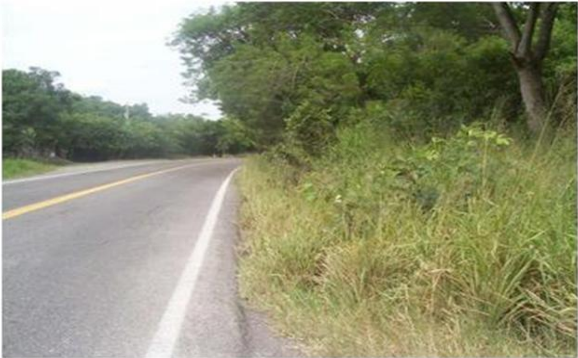
Cuneta azolvada sin zampeado
