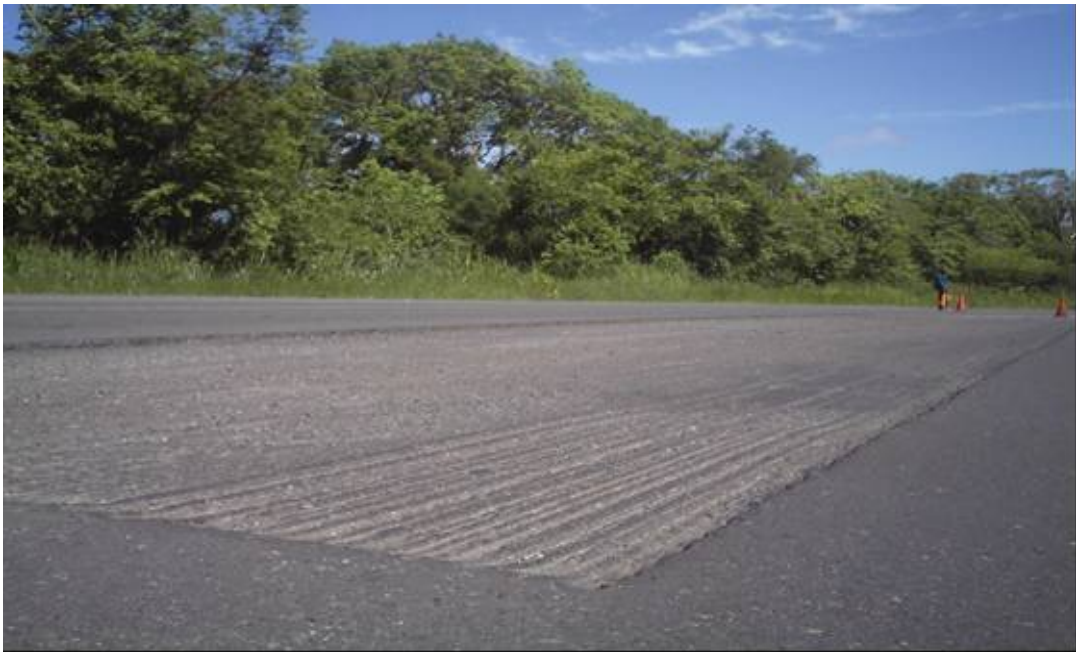
Zona deformada en la que ya se retiró mediante fresado la superficie agrietada.
