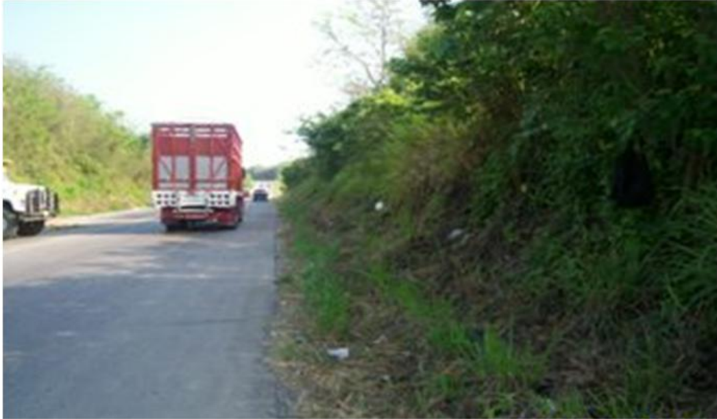
Derrumbe que afecta únicamente la cuneta.
