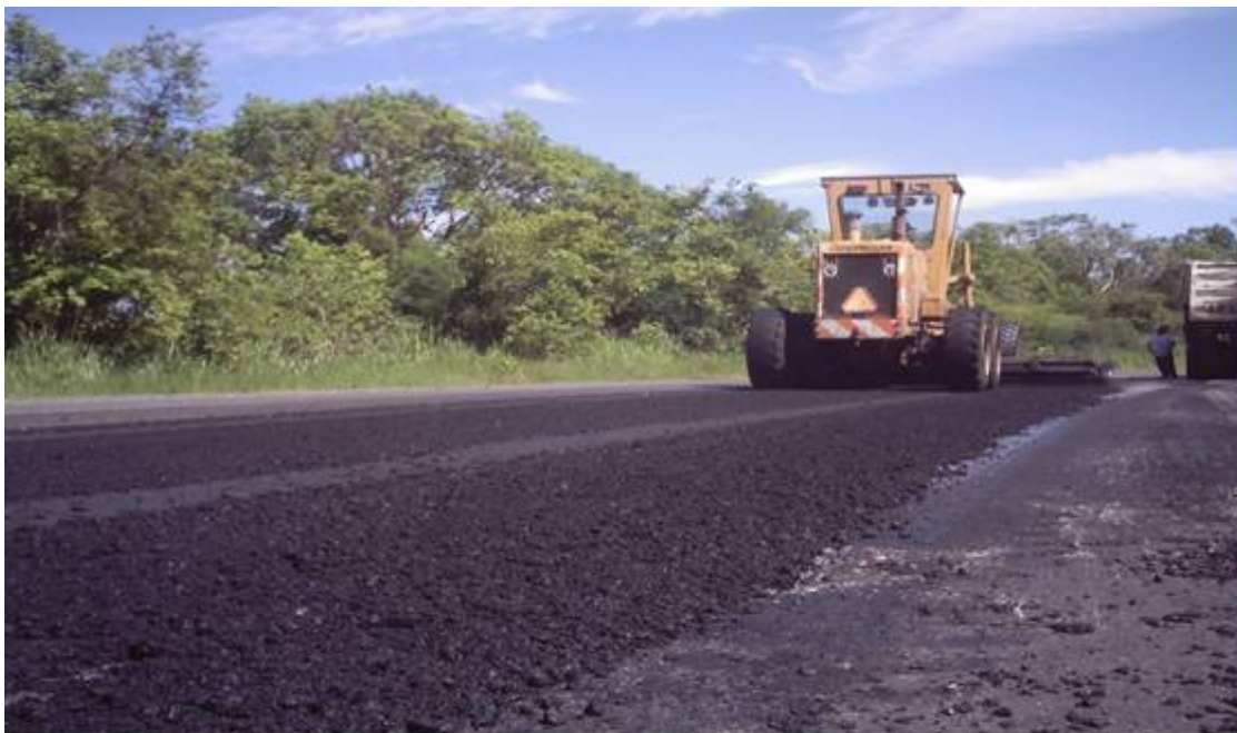
Tendido de mezcla asfáltica con motoconformadora para recuperar la sección original del camino.
