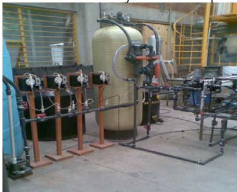
Figura 40: Planta desalinizadora piloto instalada
