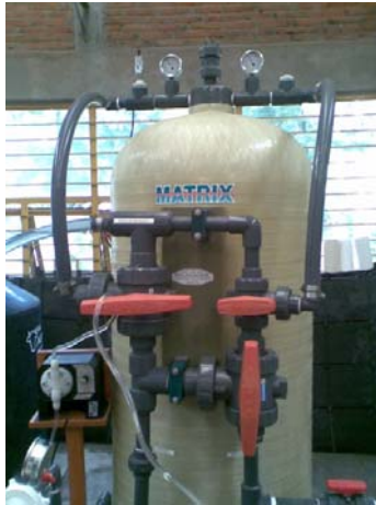
Figura 23: Filtro Multimedia planta desalinizadora piloto
