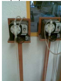
Figura 27: Bombas dosificadoras planta desalinizadora piloto
