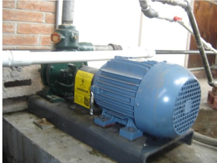
Fig.3.6. Bomba de agua utilizada.
