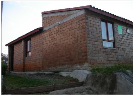
Foto exterior. La altura de la vivienda hace que se concentre el calor ya que, no hay suficientes vanos para que se tenga una circulación del aire. Fuente: La Autora Nov. 2010.
