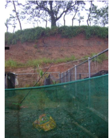
Imagen. Limite al norte de la CR, después de 1 año de habitarla todavía no se han realizado la protección necesaria.
