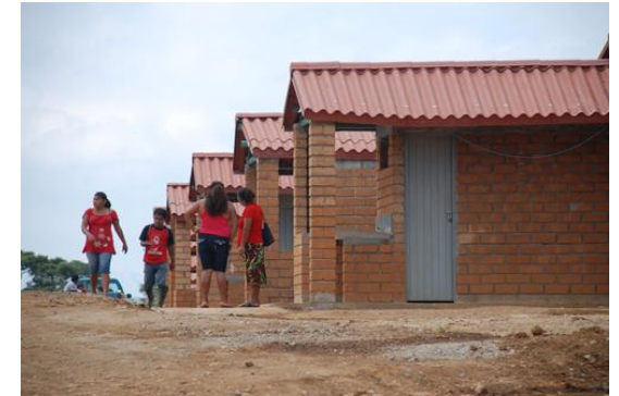
Imagen del Proceso Constructivo de la Ciudad Rural Juan del Grijalva. Imagen tomada de Internet para Fines Didácticos.
