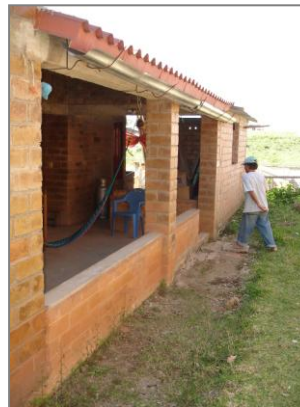
Imagen de la entrada de una de las viviendas, en su condición actual. Sin elementos de protección, los cuales son importantes en el momento de utilizar sistemas constructivos alternativos como es el Adoblock
