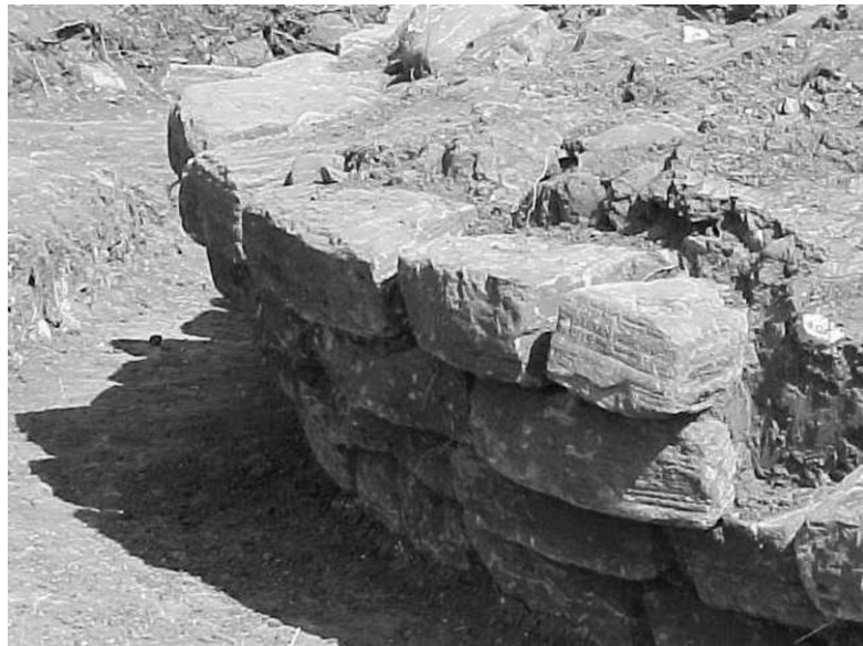
Fig. 52 Sección vencida del talud.
