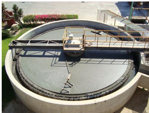
Figura 4.8. Reproducción con permiso del O.O.M.S.A.P.A.S. LA PAZ. Sistema de espesamiento de lodos.
