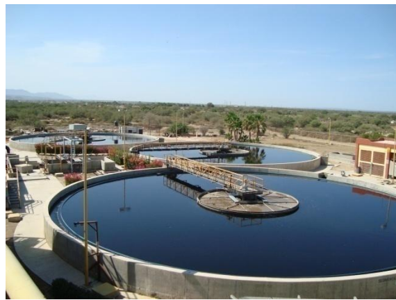
Figura 4.5. Reproducción con permiso del O.O.M.S.A.P.A.S. LA PAZ. Tanques de sedimentación secundaria del caso de estudio.
