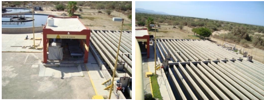
Figura 4.6. Reproducción con permiso del O.O.M.S.A.P.A.S. LA PAZ. Del lado derecho se observa la caseta de cloración, y del lado izquierdo la cámara de contacto de cloro donde se lleva a cabo la inhibición enzimática.
