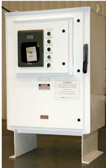
Figura 2.20 Variador de frecuencias.
