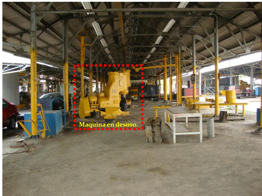
Taller de pailería y fragua. Ubicado el medio de los talleres máquinas herramientas (lado izquierdo) y soldadura (lado derecho). Foto: José Rodríguez Badillo. Reproducción realizada con fines didácticos
