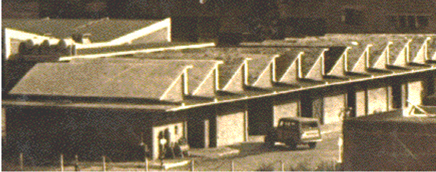
Cubierta tipo shed en talleres de instalaciones de PEMEX. Reproducción realizada con fines didácticos.
