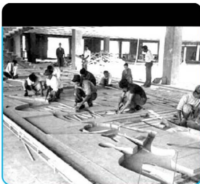
Foto No. 76: Fabricación in situ de la formaleta para los alto relieves del Crédito Hipotecario Fuente: Archivo Crédito Hipotecario Nacional (1962)
