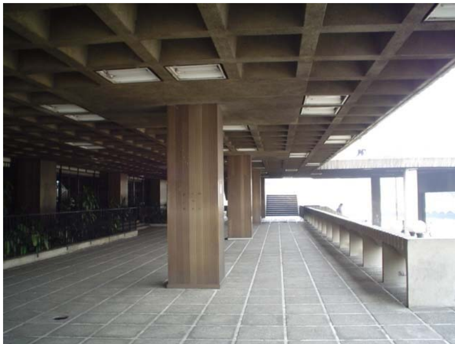
Foto No. 85: Sótano Banco de Guatemala columnas de hormigón armado+losa nervada del entrepiso Fuente: Sonia Fuentes 2005
