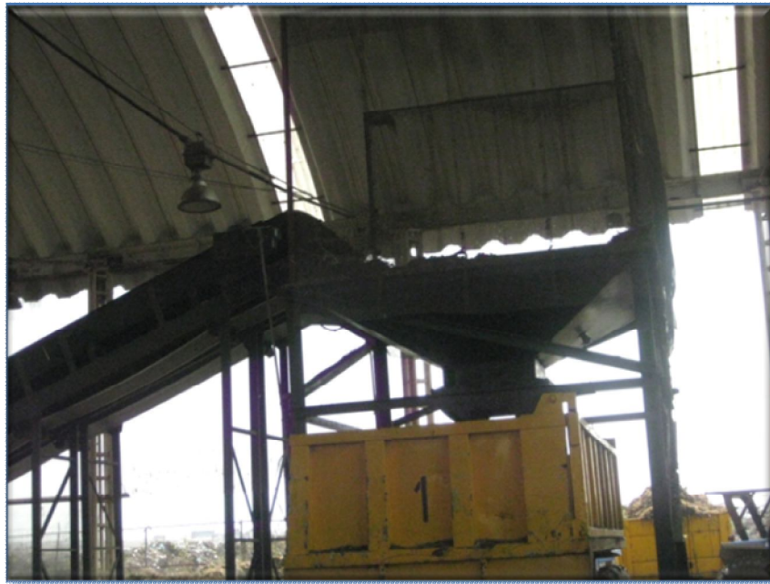
Fotografía 2. Trituradora de la planta de composta de Bordo Poniente
