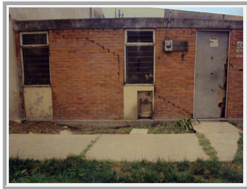
Foto 3.0 Casa dañada por las grietas
