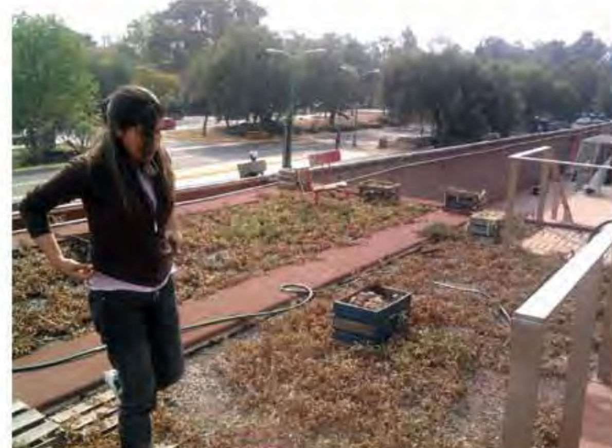
Cobertura Verde en azoteas.
