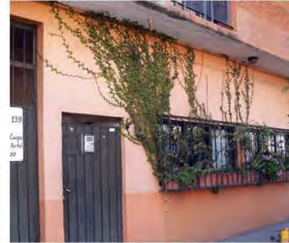
Enredaderas de maceta retomando fachada.
