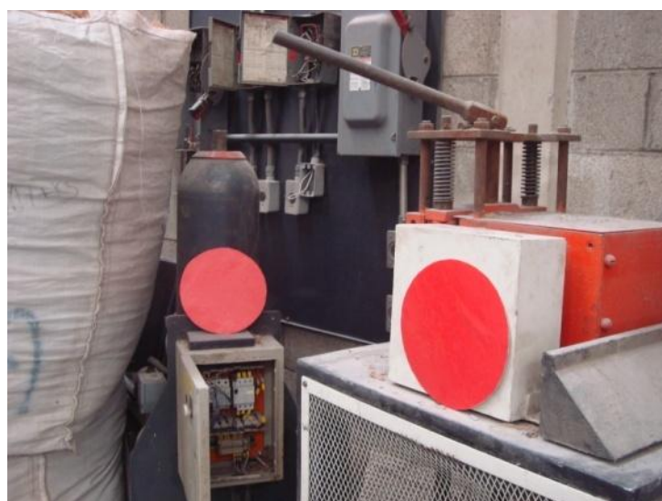
Fig. 55 Falta de señalización en terminales eléctricas.
