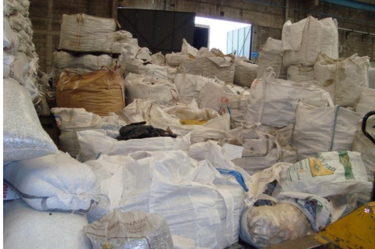
Fig. 52 Área de almacén donde se observa que hay obstrucción de la salida de emergencia.
