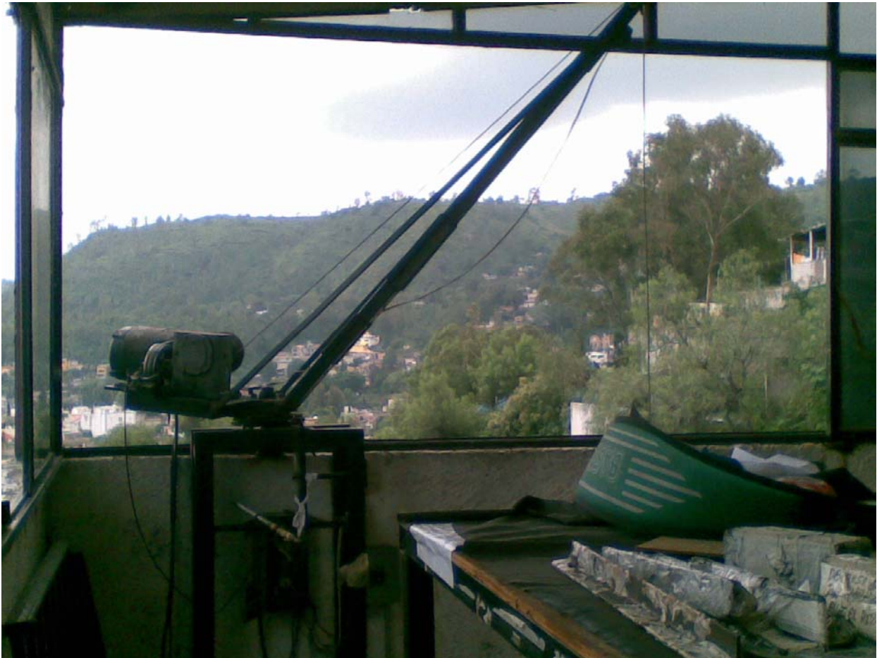
Imagen 16 Grúa utilizada para subir las materias primas.
