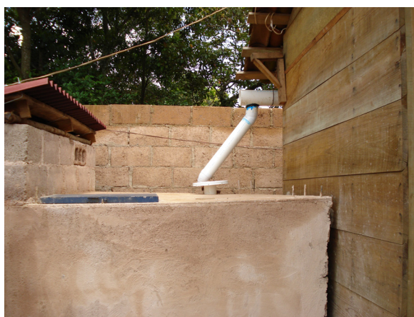
Foto 66; Conducción del agua de lluvia captada en la teja de barro hacia el tanque.
