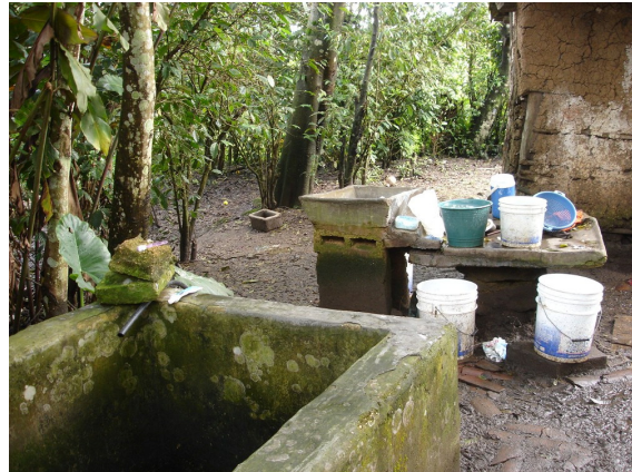
Foto 8; Tanque sin cubierta
