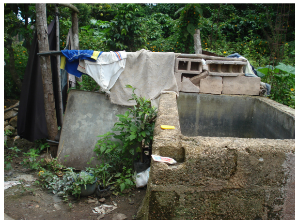
Foto 26; Tanque para depósito de agua.
