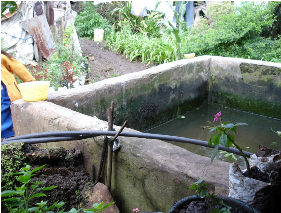
Foto 7; Tanque de almacenamiento de agua
