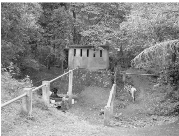
Foto 3; Caseta de captación de agua por bombeo en el arroyo “El Zapote”
