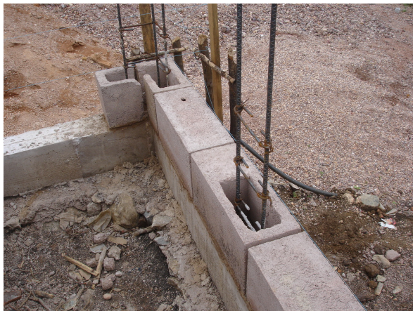
Foto 55; Cimentación de mampostería con piedra del Lugar, cadena de desplante y paredes de block.
