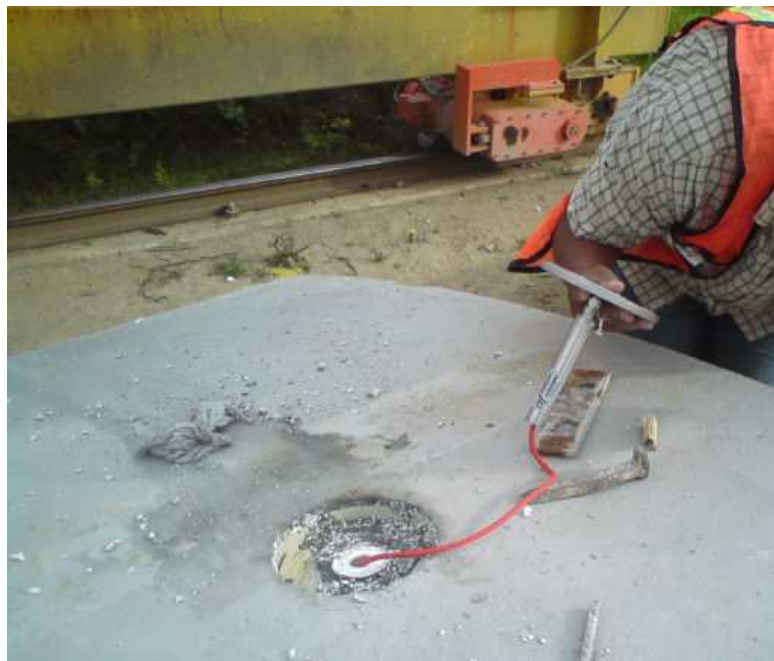
Fig. 5 Celda de presión colocada en dovela.
