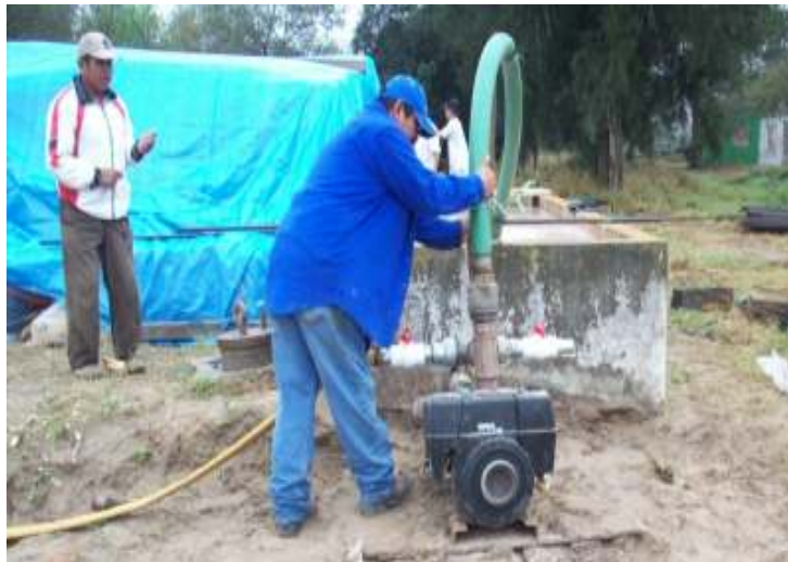
Almacén de lodo bentonítico
