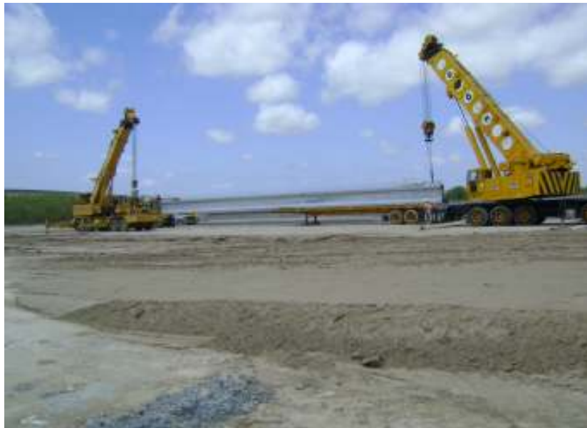
Movimiento de traves para dejar lugar para el colado de otras traves.
