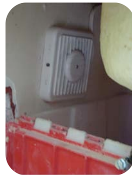
⦿Sistema de ventilación 2
