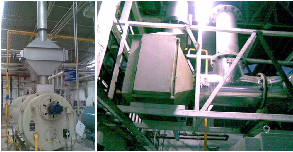
a) Acoplado a caldera
