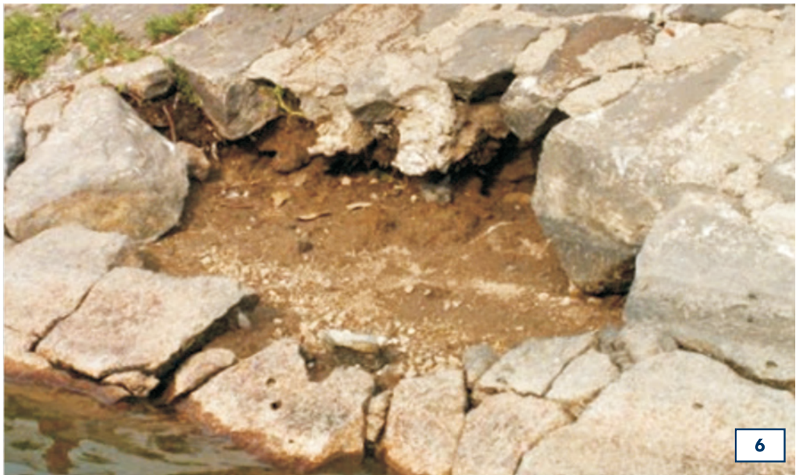
Instalaciones. Deterioro y falta de mantenimiento así como falta de cimentación adecuada en las instalaciones.
