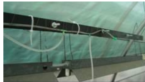
Tubería de distribución
