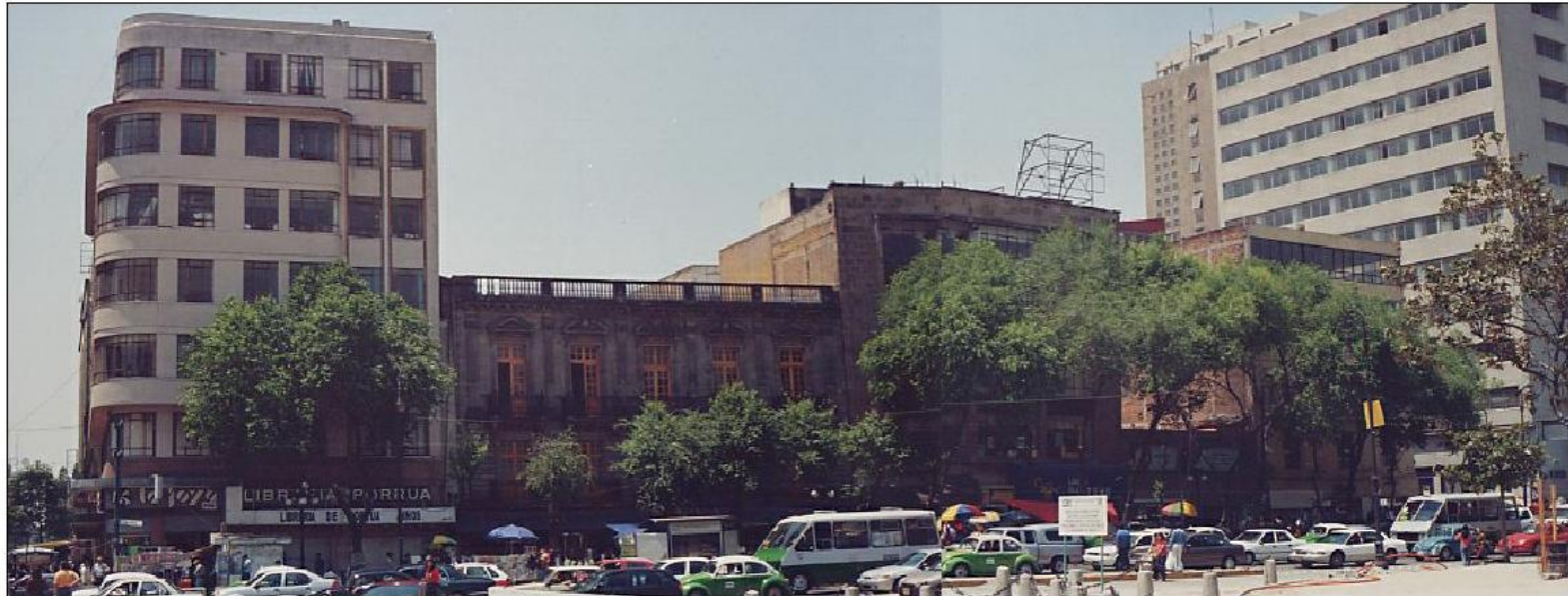
VISTA PANORAMICA DE AVENIDA JUAREZ ENTRE LAS CALLES DE LÓPEZ Y DOLORES. SE PUEDE APRECIAR LA FALTA DE MANTENIMIENTO EN LAS FACHADAS DE LAS EDIFICACIONES, ADEMÁS ES NECESARIO HACER EL RETIRO DE LA ESTRUCTURA METÁLICA QUE SIRVIÓ EN ALGUN MOMENTO PARA UN ANUNCIO ESPECTACULAR.
