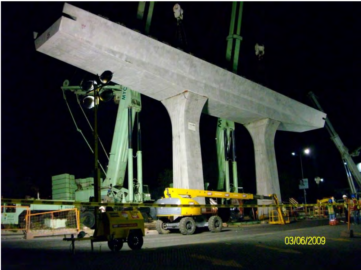
La noche del 2 de Junio de 2009 se colocó la trabe 1 TARE 8 sobre los apoyos A-75 y A-76
