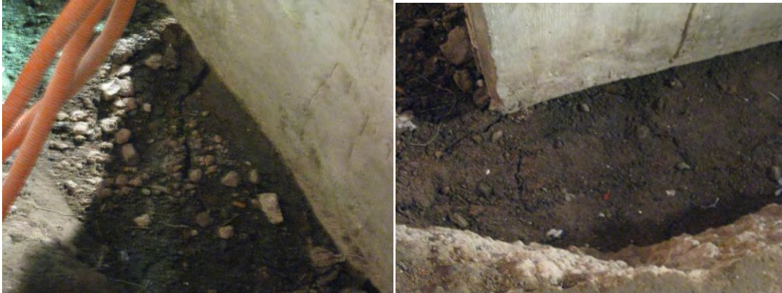
Vista General de las grietas que prueban las deformaciones inducidas en el terreno
