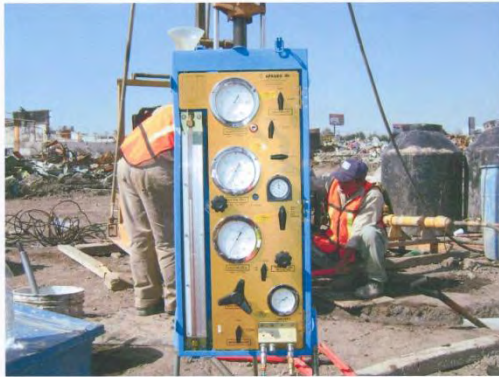
Foto 3 Detalle del gabinete de control
