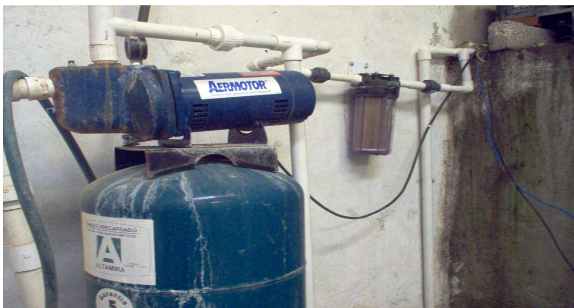
Foto 16. Una bomba hidroneumática de la marca Aermotor con potencia de 1.5 hp y de fabricación estadounidense prácticamente “jala” el agua de la toma municipal conectada a la planta purificadora para llenar con mayor rapidez los tinacos de almacenamiento de esta planta, nótese, también, el filtro ubicado entre la toma y la bomba.
