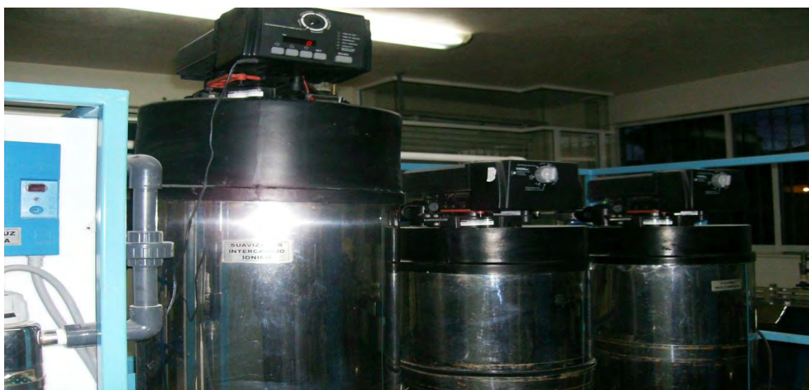
Foto 22. Tinaco suavizador de intercambio iónico
