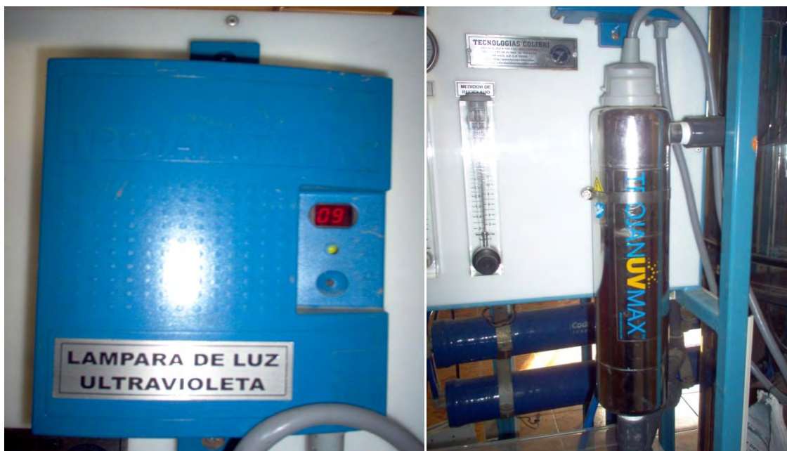
Foto 25. En su recorrido de purificación el agua es irradiada por la luz ultravioleta que elimina todo microorganismo que es alcanzado por este tipo de radiación y el equipo semicomputarizado se encarga de indicar el periodo de utilización en meses de la UV.
