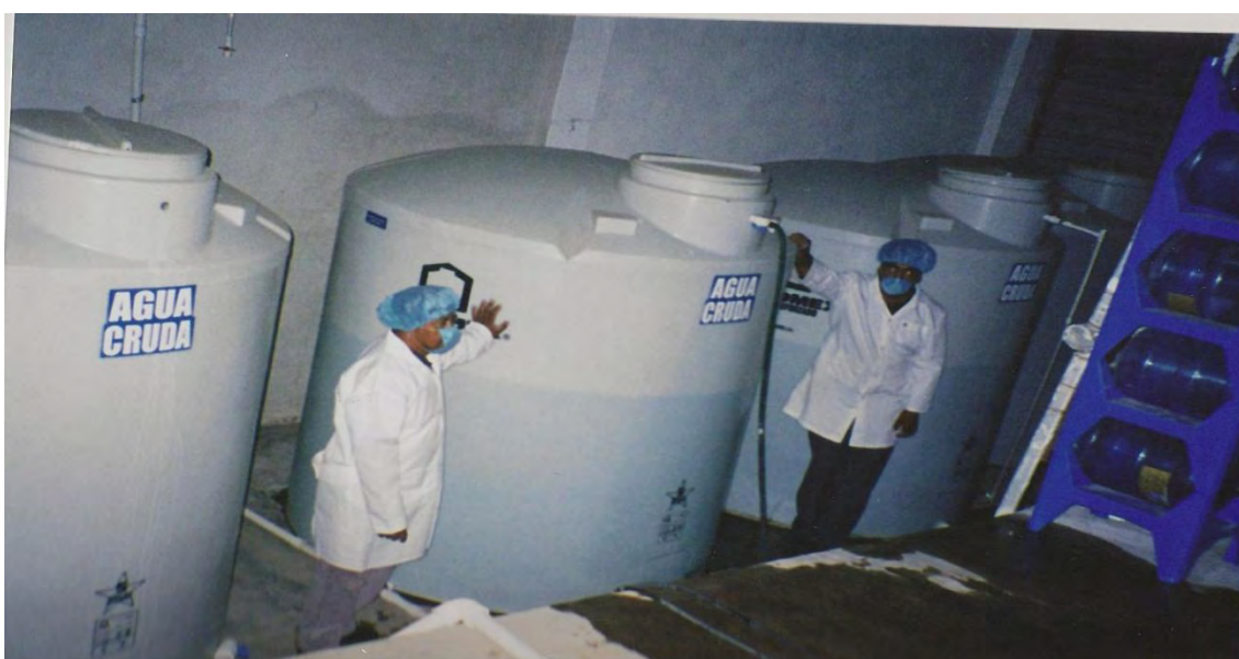
Foto 17. Tinacos de almacenamiento de agua cruda de la planta purificadora Bio Light
