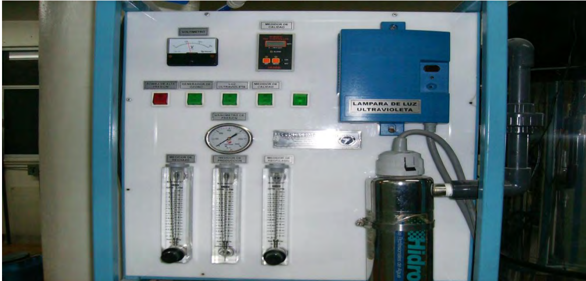
Foto 19. Tablero de control de la planta purificadora Bio light e la que se pueden observar los diferentes dispositivos que indican el buen funcionamiento de cada uno de los aspectos tecnológicos que se aplican al proceso de purificación del agua.
