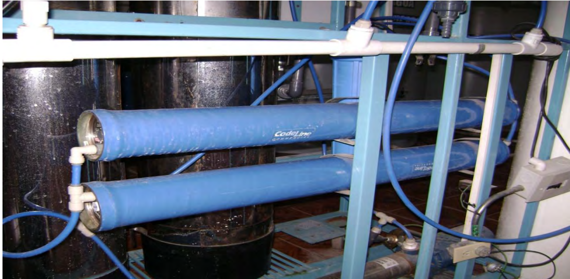
Foto 24. Tubos que contienen las membranas de osmosis inversa, las cuales no dejan pasar microorganismos ni metales pesados existentes en el agua debido al tamaño de los poros que la conforman.
