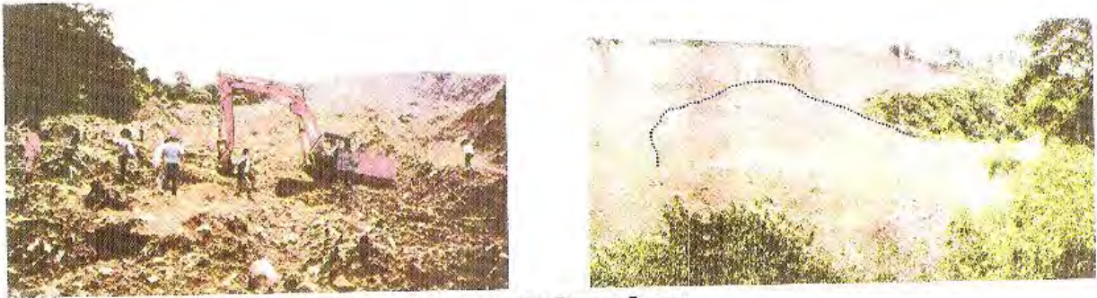
Deslizamiento de la Barranca Becerra
