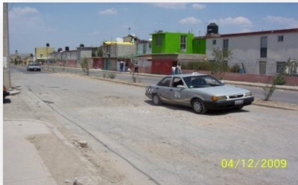
Ilustración 23 Deterioro de las vialidades en la Colonia Lomas de Cuautitlan 98
