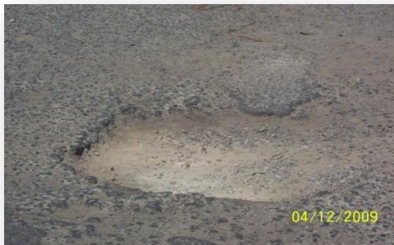
Ilustración 25 Deterioro del estacionamiento de OPERAGUA 101
