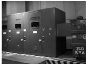
Imagen 23 Planta de Emergencia Interruptores
