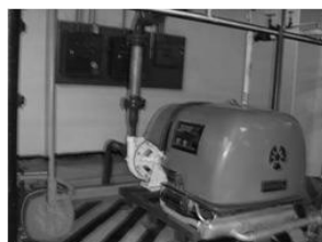
Imagen 30 Bomba para Agua Caliente
