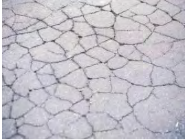
Figura 2.8. Agrietamiento por fatiga en la carpeta
