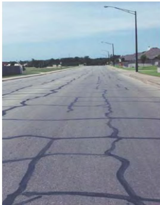
Figura 3.1. Reflexión de grietas en un pavimento cuya base fue estabilizada con cemento (Hanson, 2006)
