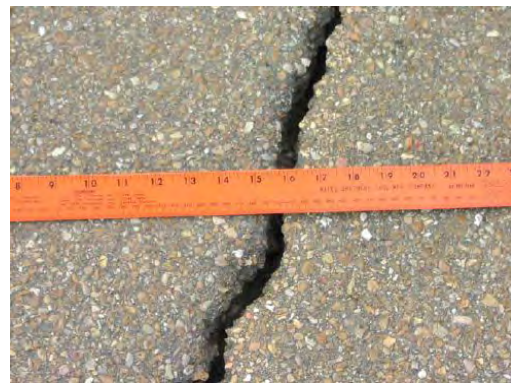
(b) Espesor de la grietas
