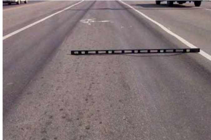
Figura 2.12. Roderas sobre la carpeta asfáltica
