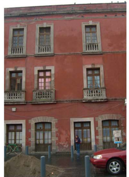
Parte de la fachada que da hacia la plaza Juan José Baz.
