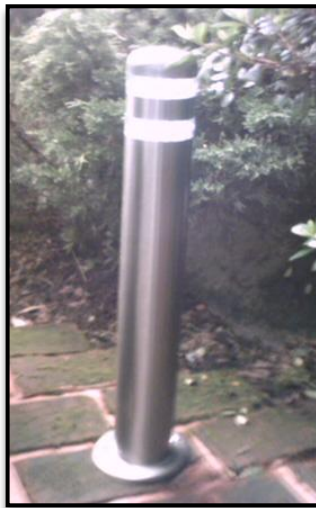
Figura 4.5a: Fotografía de luminaria LED instalada en el sitio de estudio
