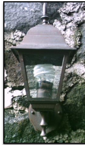
Figura 4.5b: Fotografía de luminaria ahorradora instalada en el sitio de estudio
